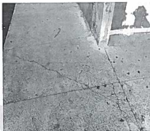
Foto 13 – Rachadura no pé do Pilar 26
