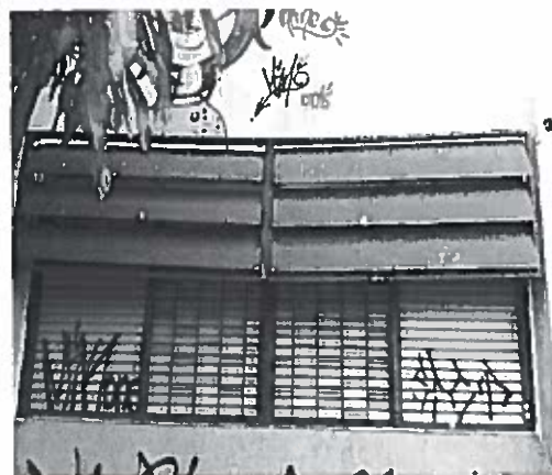
Foto 15 – Brise entre pilares 93 e 83
