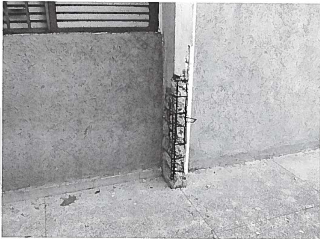
Foto 10 – Pilar 37 – Sem recobrimento
