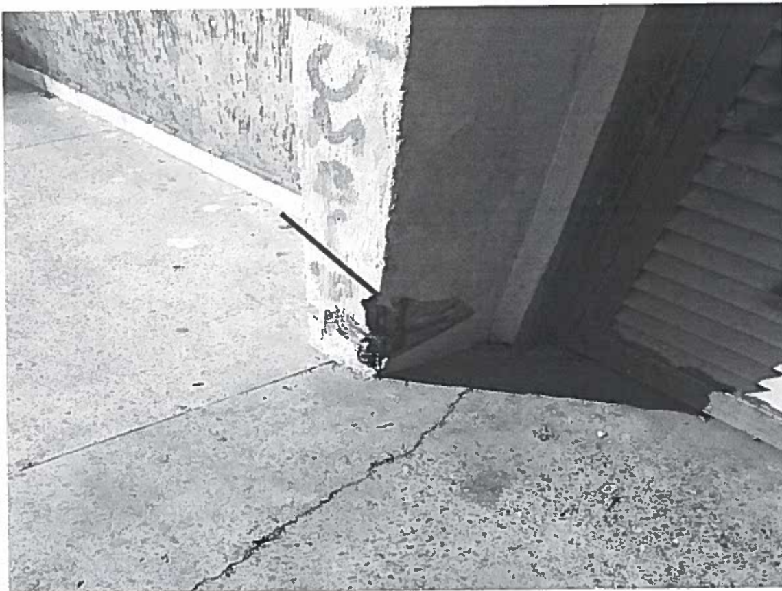
Foto 08 – Pilar 65 – Sem recobrimento
