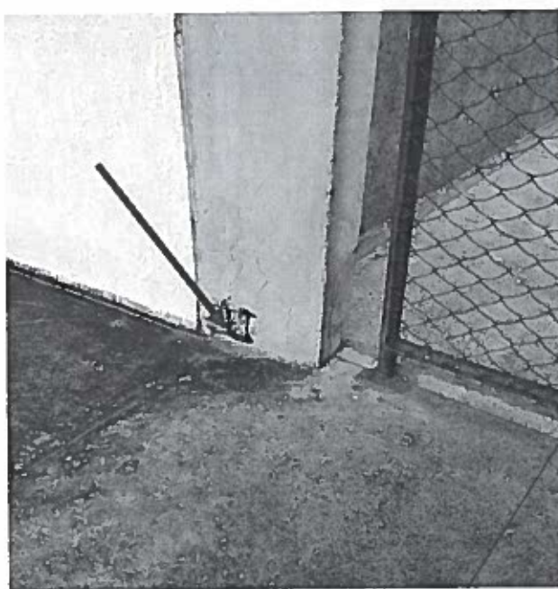
Foto 09 – Pilar 8 – Sem recobrimento
