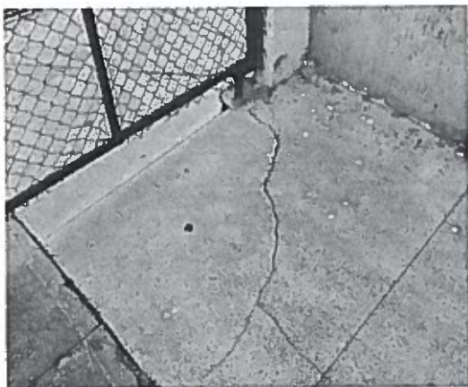
Foto 12 – Rachadura no pé do Pilar 26
