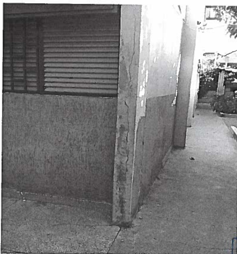
Foto 03 – Pilar 84 – Rachadura vertical no canto e base do pilar
