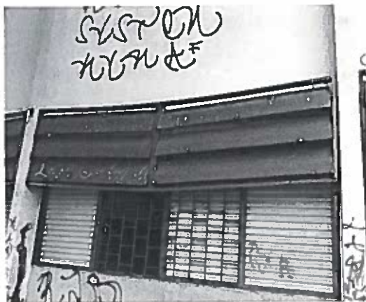
Foto 14 – Brise entre pilares 136 e 115
