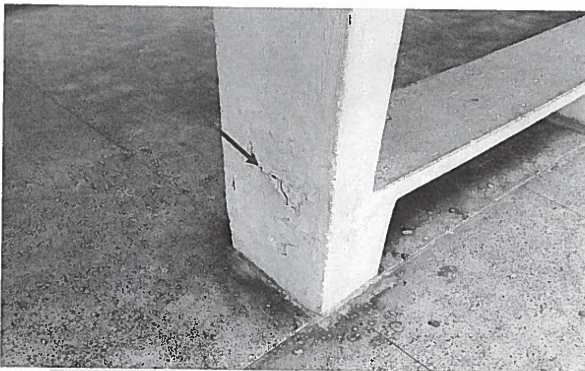
Foto 06 – Pilar 7 – Rachadura vertical na base do pilar
