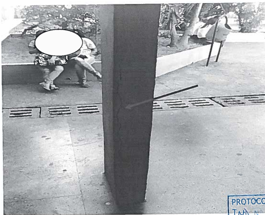
Foto 01- Pilar 59 – Rachadura vertical no canto do pilar
