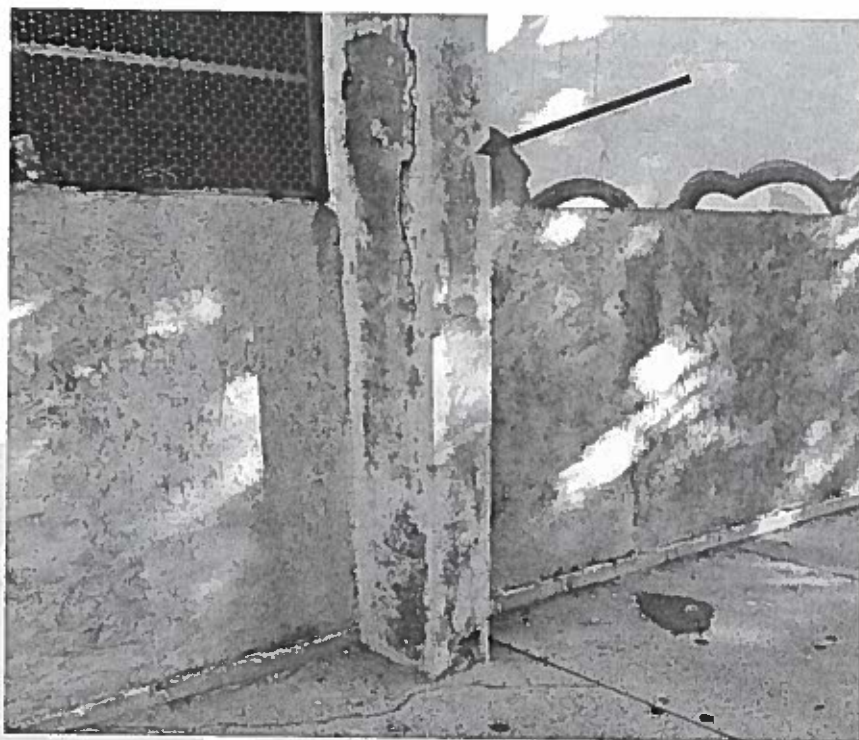
Foto 02 – Pilar 49 – Rachadura vertical no canto e base do pilar
